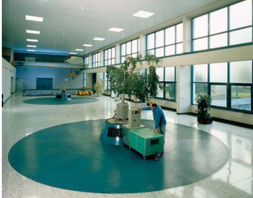
La salle des machines
