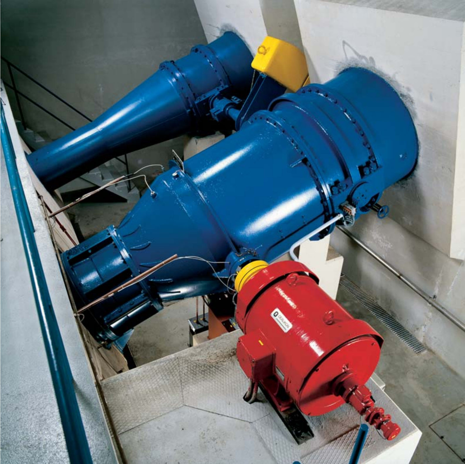
La minicentrale à débit de dotation
