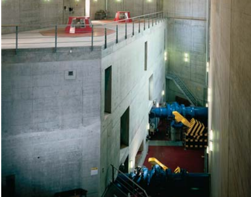
Salle des machines
