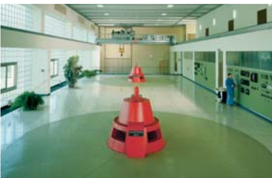
La salle des machines
